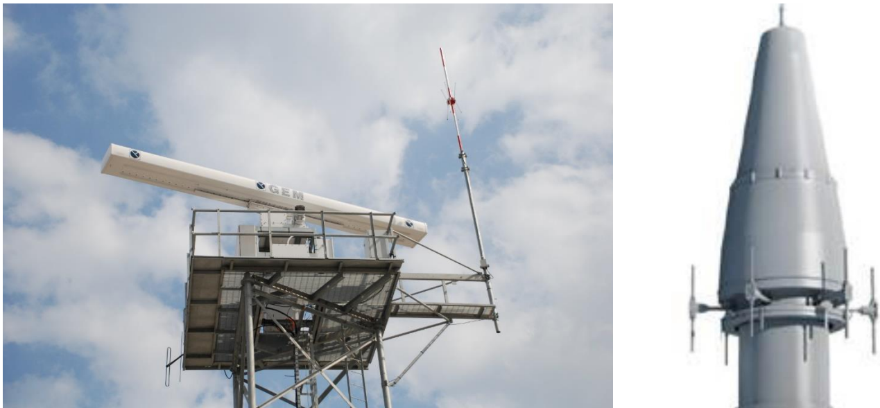
Figuur 15: Voorbeelden van radar en RDF in dezelfde mast [Bron: Rho Theta, Rohde & Schwarz]
