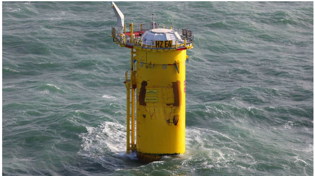
Afbeelding 2: Schade windturbine fundatie na aanvaring Julietta D
